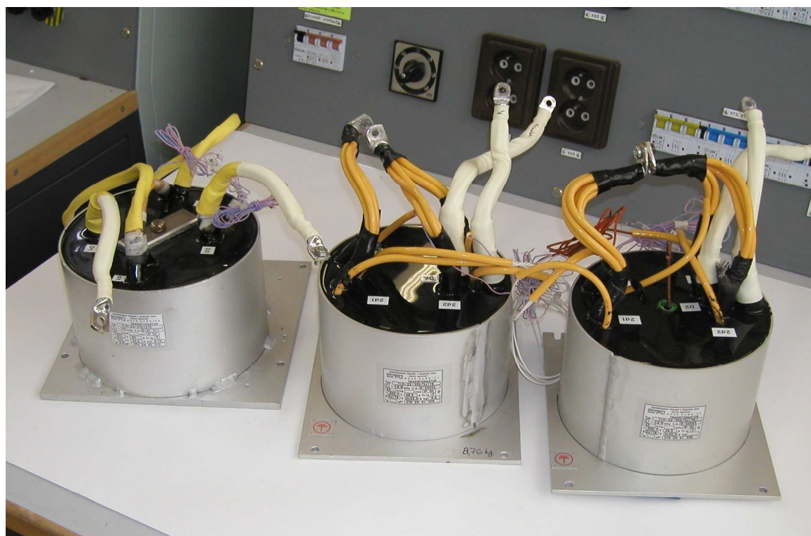
Obr. 1: Transformátory 24kVA, 2 kVA, 22kVA s tepelnou trubicou
